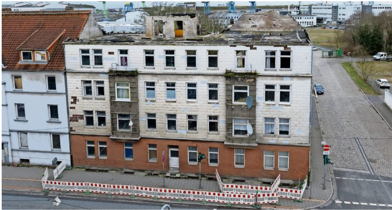
Der Verfall wird zur Gefahr für Passanten: Deshalb ist der Gehweg vor der Brandruine an der Georgstraße vorerst abgesperrt worden. Foto Masorat
