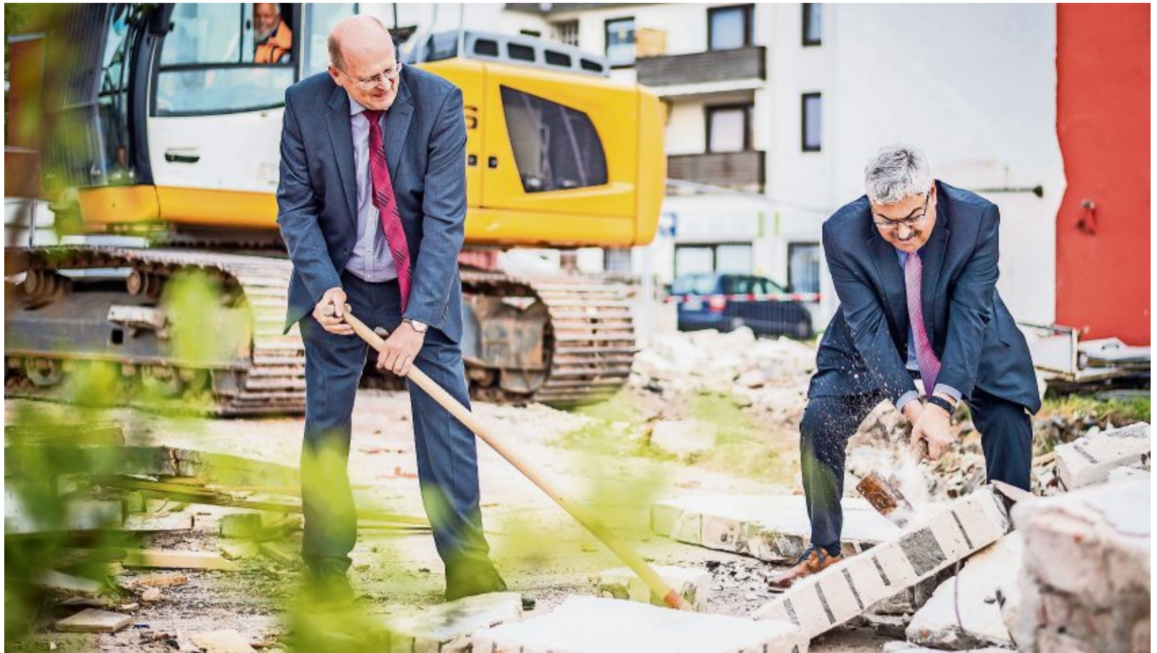
Symbolischer Start für die Abrissarbeiten in Wulsdorf: Oberbürgermeister Melf Grantz (rechts) lässt den Vorschlaghammer auf eine der bereits mit schwerem Gerät eingerissenen Wände krachen. Den ersten Schutt nimmt Dieckell-Geschäftsführer Dirk Grotheer auf die Schippe. Fotos: Hartmann
