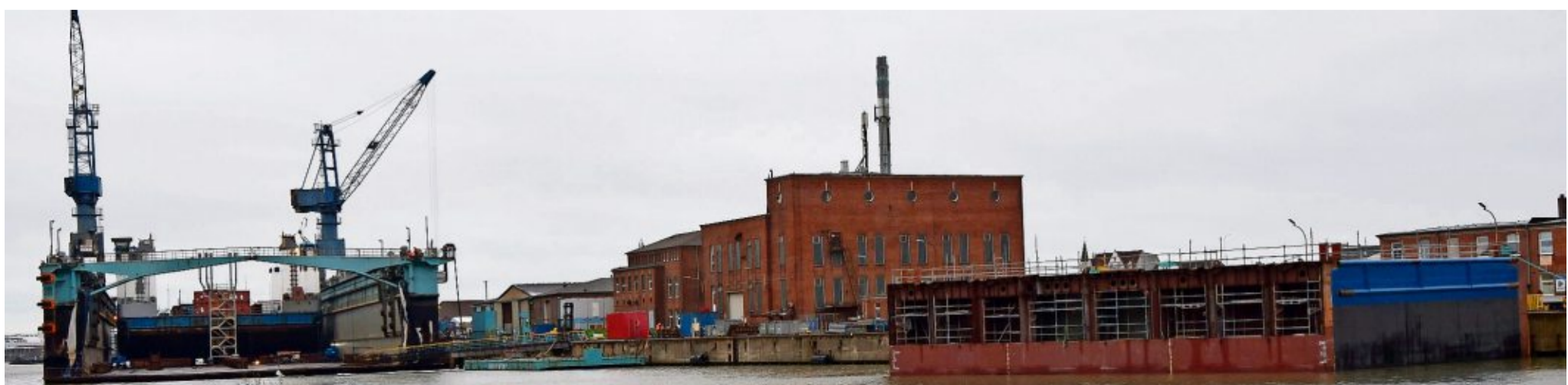
Im Schwimmdock V wird zurzeit der Schwerlastponton „Offshore BHV 1“ auseinandergeschnitten. Anschließend wird eine Sektion dazwischengesetzt. Die 25-Meter-Verlängerung (rechts im Bild) liegt im Kaiserhafen I bereits in Warteposition.
